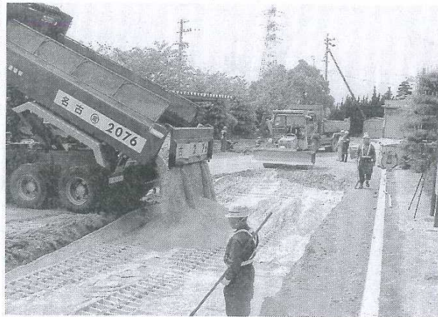
東浦町役場で行われたガラスカレットを用いた雨水対策工事
