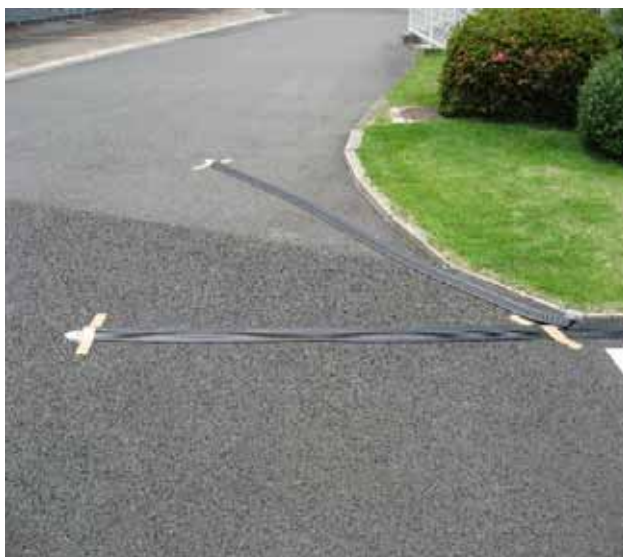
写真6.2 計測装置設置の様子
